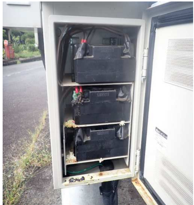
バッテリーの液漏れ
