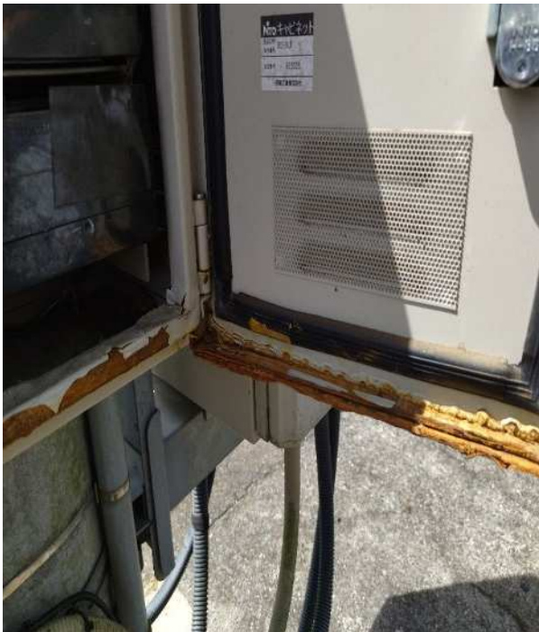
収納ボックスの腐食
