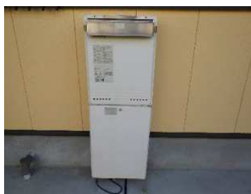
沢脇団地給湯器
