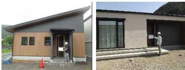
定住促進住宅建設事業費補助金を活用した住宅の新築
