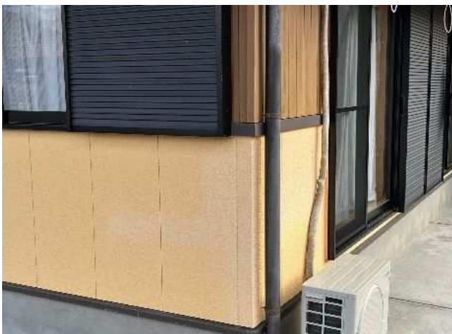
劣化状況(外壁)
