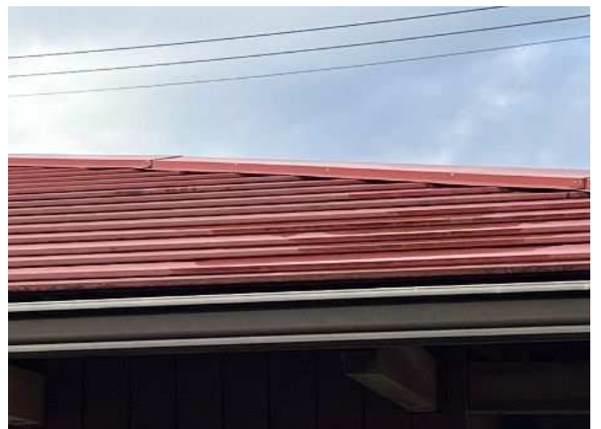
劣化状況(屋根)
