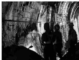
悉太トンネル（偏圧による歪み）
