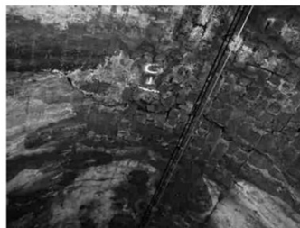
澤間トンネル（覆工のひび割れ）
