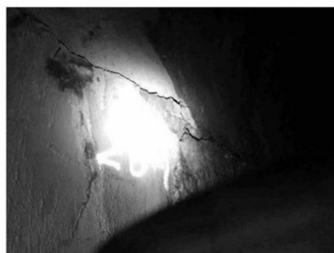
田野口トンネル（覆工の剥離）
