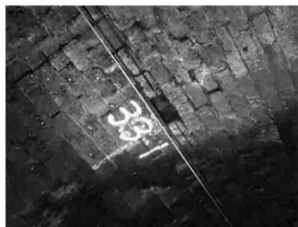
笹間トンネル（覆工ブロックの抜け）
