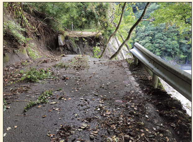
台風24号により被害を受けた町道閑蔵支線
