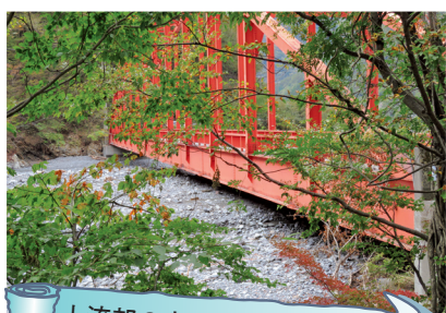
上流部の土砂崩れにより堆砂が進む畑薙第1ダム上流部の橋の様子
