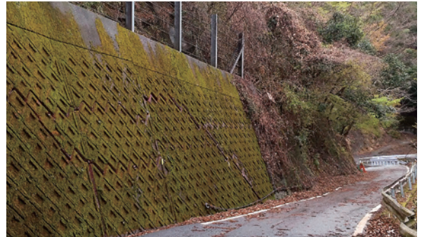
地滑り現場の状況 ブロックにひび割れ
