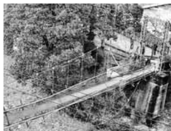
天竜区橋梁事故
