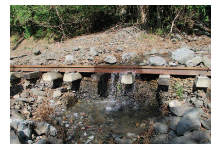
▲下泉～田野口間の線路の様子
