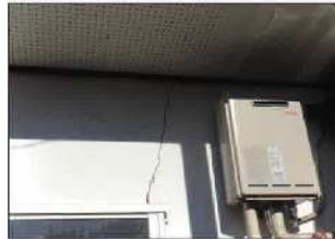
【モルタル塗り仕上等】 開口隔断部廻りにわずかなびみれが生じている。
