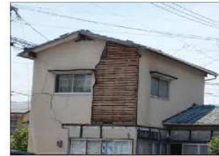
【モルタル塗り仕上等】 仕上材が脱落している。
