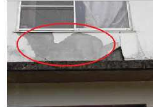
【モルタル塗り仕上等】 仕上の剥離が生じている。
