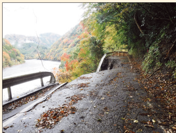
町道桑野山細尾線の災害現場（台風21号の影響）
