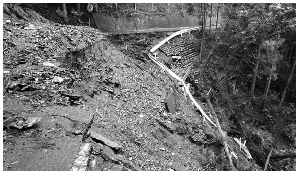
被害を受けた町道水川藤川線
