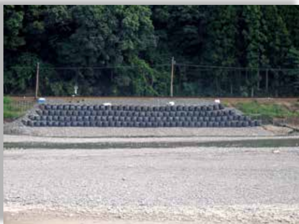
大鐵大井川本線は、令和2年7月豪雨により護岸が崩落し運休した。梅島下南部より対岸の護岸仮設補修現場を望む。
