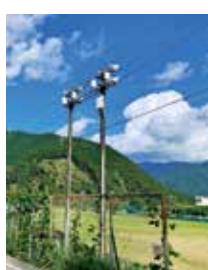
本中グラウンド夜間照明施設
