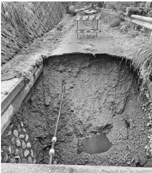
陥没した農道三津間線2号
