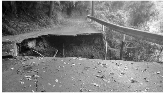
町道長松線の道路陥没現場
