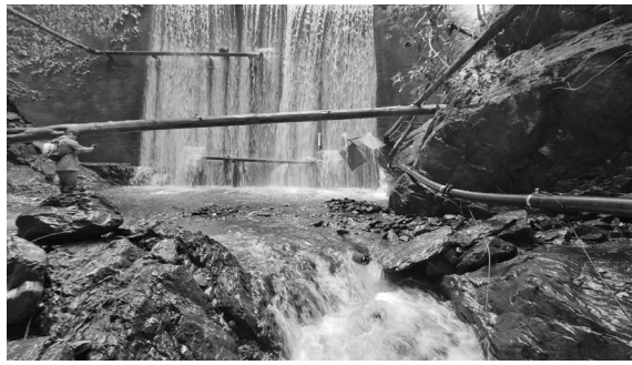
中部簡易水道高郷浄水場の破損した取水口
