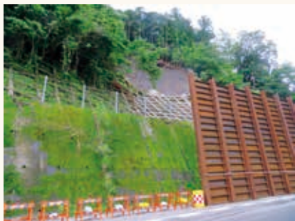
地名・土砂崩れ現場・令和3年3月24日
