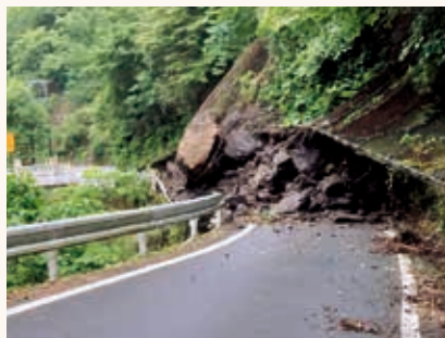
寸又峡線落石状況・令和3年6月23日
