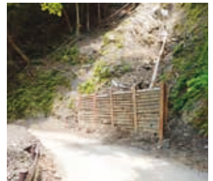
林道南赤石線の崩落現場
