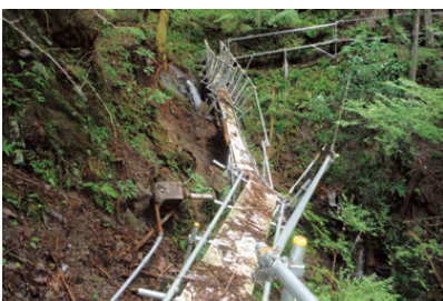
7月の大雨により崩落した水源施設管理道路(原山地区)
