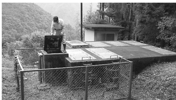
向井飲料水供給施設
