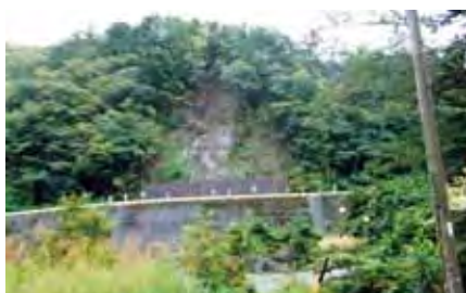
対岸から見た崩落現場
