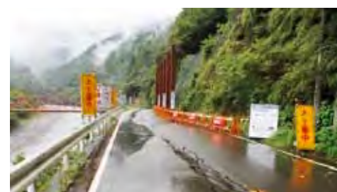
崩落現場の片側通行
