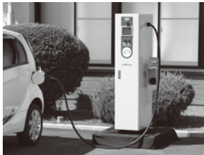
電気自動車用充電施設の設置例 (写真はイメージ)
